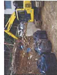
道路の土砂撤去 【安佐南区八木4丁目】
