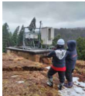
基地局の損壊
