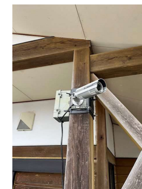
防犯カメラの設置
