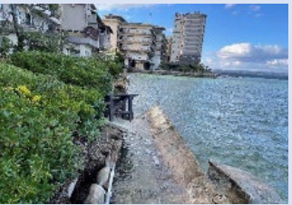
旅館背後で倒壊した護岸 (和倉港)
