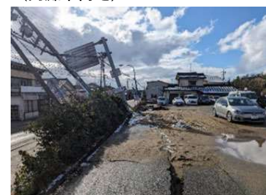
液状化被害 （内灘市街地）
