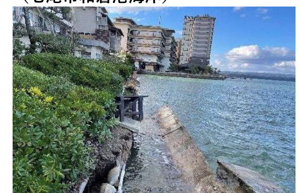
旅館背後で倒壊した護岸 （七尾市和倉港海岸）
