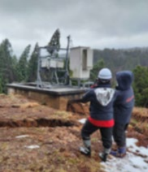
通信基地局の損壊
