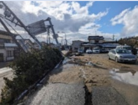
液状化被害 (内灘市街地)
