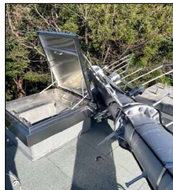
送信アンテナの損壊
