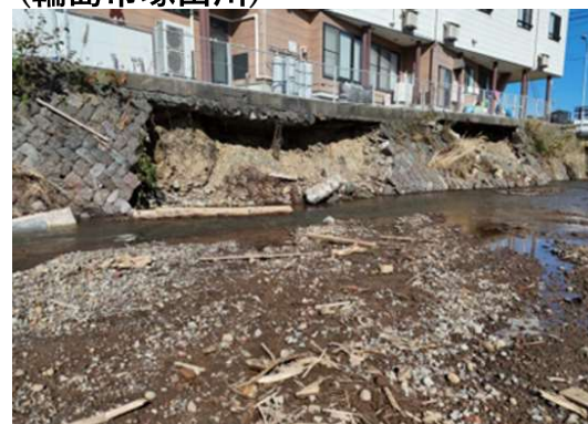
豪雨で被災した河川護岸 （輪島市塚田川）
